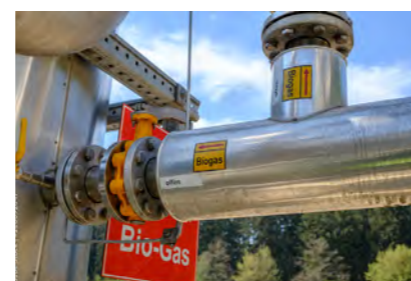
In Biogasanlagen bildet sich aus organischen Abfällen Biogas, das aus Methan und Kohlendioxid besteht.
