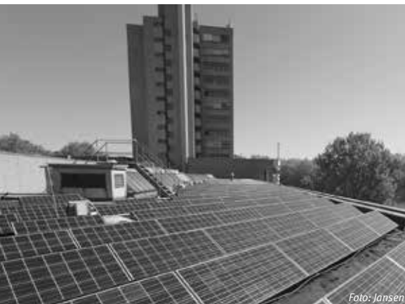
Sonnenkollektoren auf dem Dach von Haus Grashof
