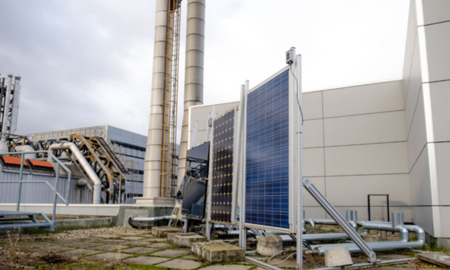
Die Solarmodule auf dem Dach von Haus Bauwesen sind Teil der Laborübungen
