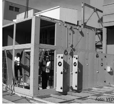
VINCI Energies Deutschland GmbH – führend im Kraftwerksbau – das Foto zeigt eine Lüftungsanlage für die Turbinenhalle des Gas- und Dampfturbinenkraftwerkes in Sloe (NL)
