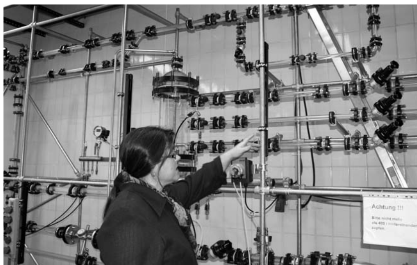
Prof. Elfriede Herzog erklärt ihren Studierenden an der simulierten Heizungsanlage, was hinter den Reglern steckt.
